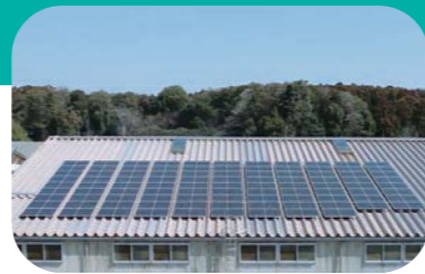
太陽光発電設備
