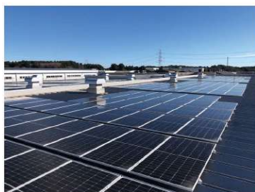
千葉北総プラントの太陽光パネル
